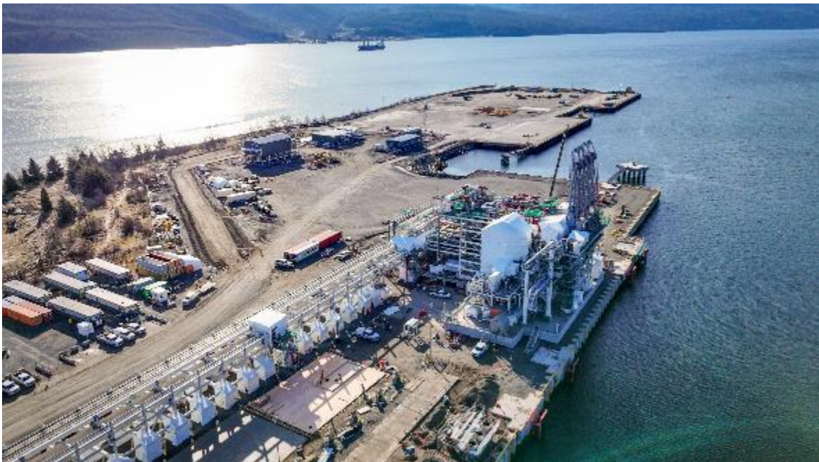
PHOTO 1: LNG LOADING MODULE AND ARMS (MARCH 2024)
